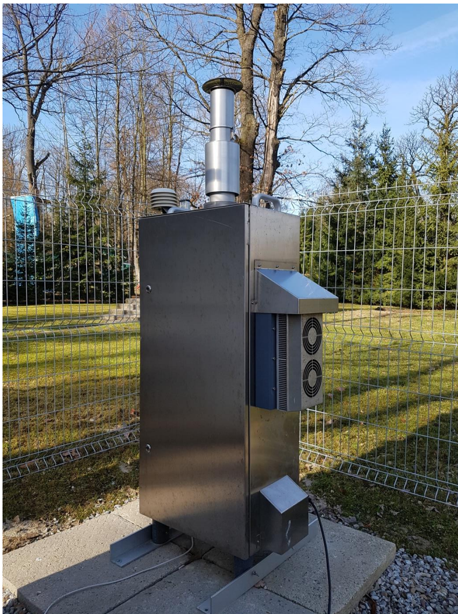
Fot.1. Pobornik pyłowy zainstalowany w punkcie pomiarowym
