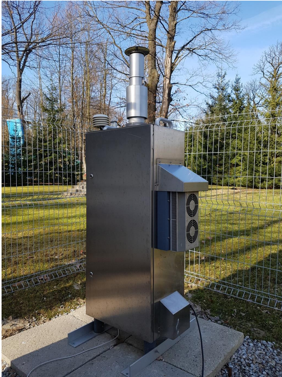
Fot.1. Pobornik pyłowy zainstalowany w punkcie pomiarowym
