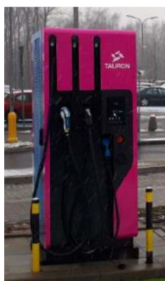
Stacja DC szybkiego ładowania
