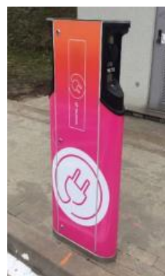
Stacja AC przyspieszonego ładowania
